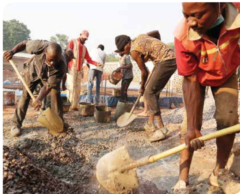
A kongói víztározó tetejének alapozásakor 23 köbméter betont dolgoztak be kézi erővel egyetlen nap alatt. Végre a helyi férfiak is lapátot ragadtak.
